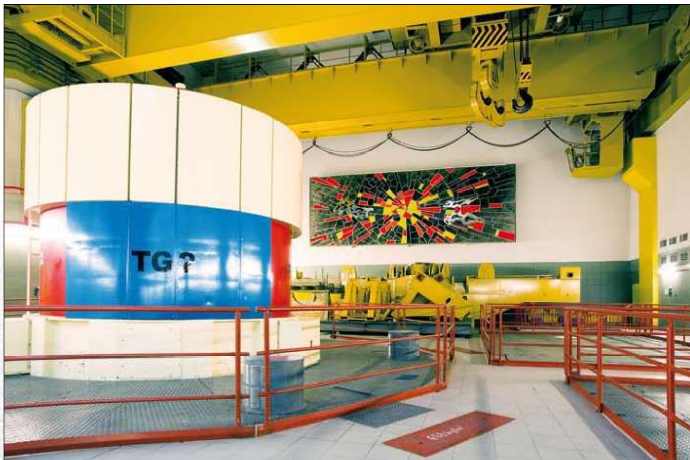
Technické zázemí elektrárny Dlouhé stráně - kaverna generátoru
