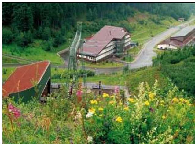
Trafostanice u dolní nádrže
