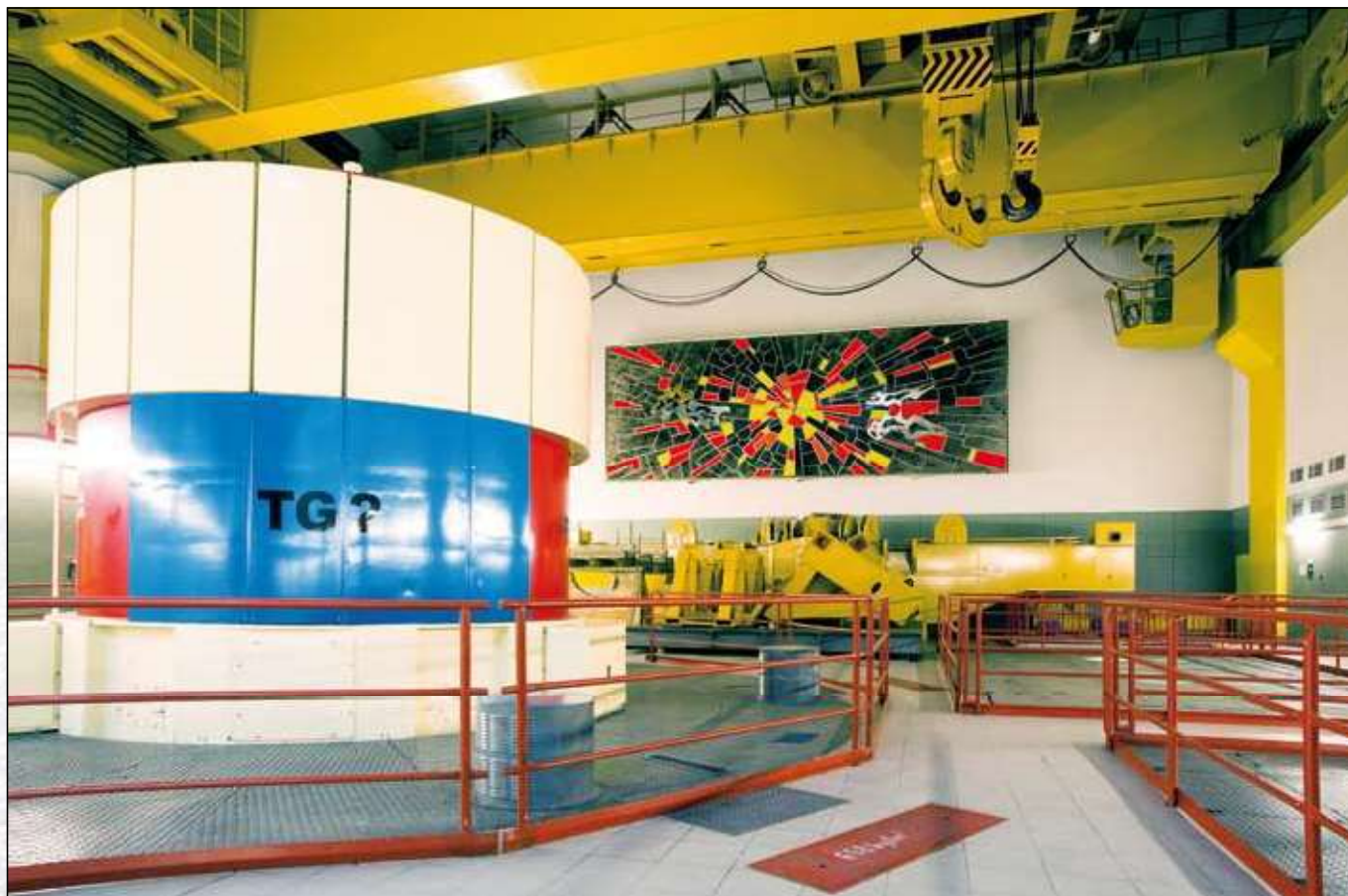
Zaplecze techniczne elektrowni Dlouhé stráně – kawerna generatorów
